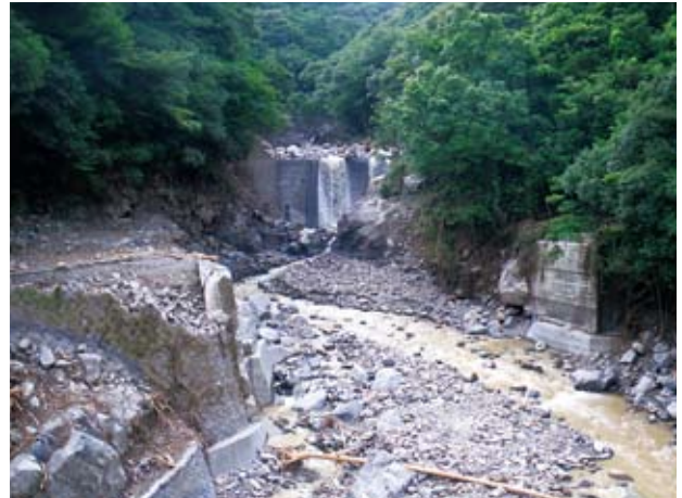
(写真－5) 小島地区の旧国道被災状況
