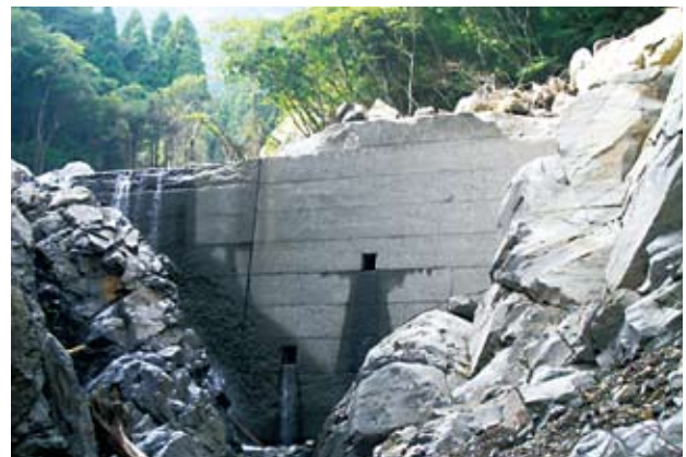
(写真－8) S.53年治山ダムの本体・袖部被災状況
