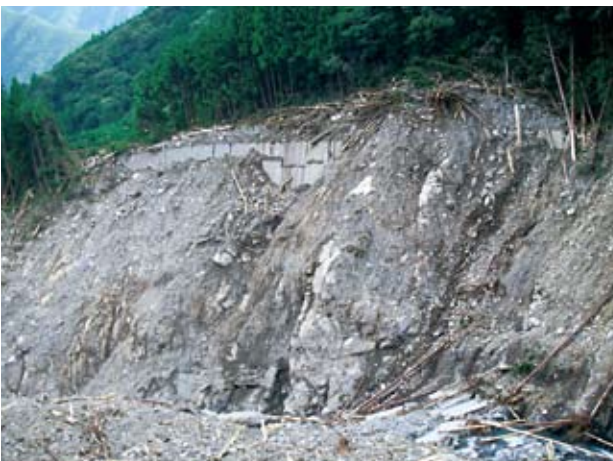
(写真－7) 林道平鍋線の被災状況
