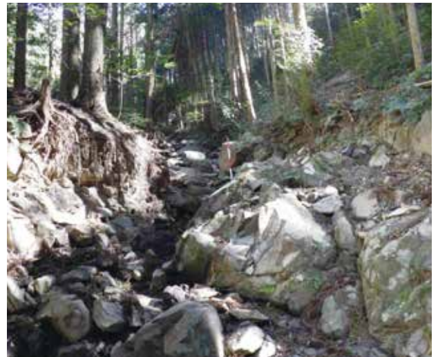
浸食を受けている溪流内
