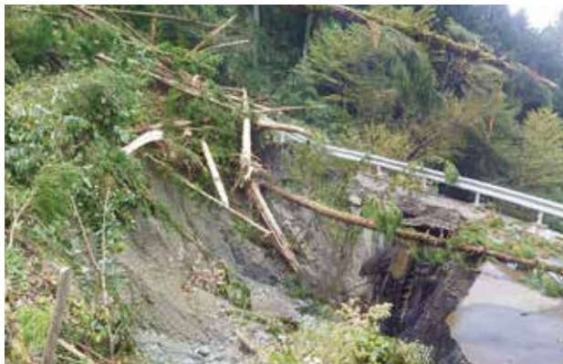
土石流によって被災を受けた林道施設
