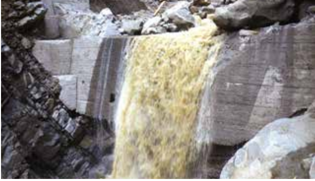
基礎の洗掘を受けながらも堤体は間詰で保護され破壊を免れている。
