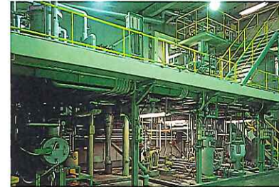
ソクシール製造プラント Polyimide SOXR Production Plant
