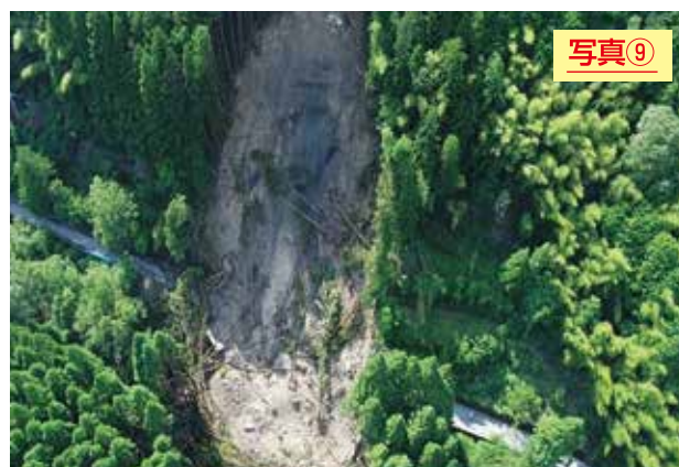
【香南市の林道畑山奥西川線の法面崩壊】
