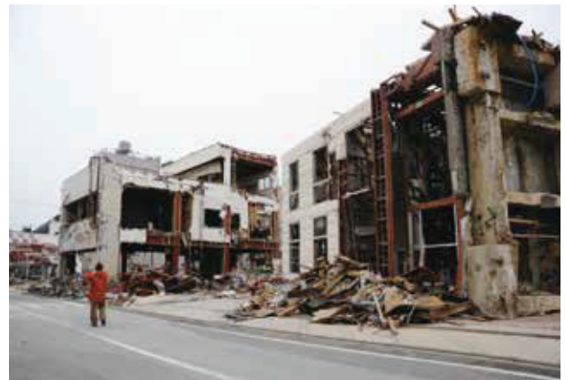
写真3 宮城県女川町中心部。手前の4階建てのビルは津波で横倒しになっており、その後の調査で基礎がなかったことが判明。施工不良の典型。
